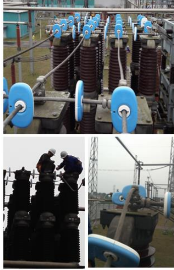
±800KV 复龙换流站
