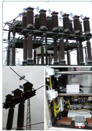
±660KV 银川东换流站
