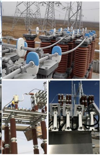
±800KV 灵州换流站
