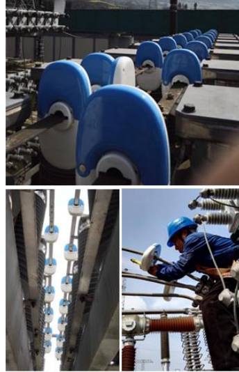
±800KV 宜宾换流站
